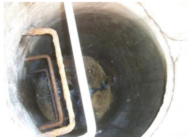
Abbildung 5: Stark angerostete Steigeisen, Schachtbankett fehlt, Schachtboden ausgemagert
