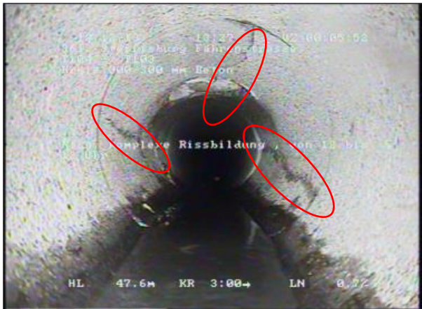
Abbildung 2: Risse in der Rohrwandung der bestehenden Leitung, Rohrwandung porös
