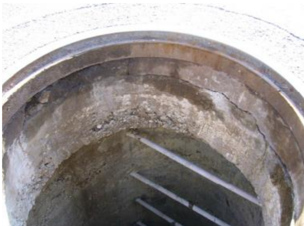
Abbildung 4: Ausbrüche und Risse im Schachtrahmen
