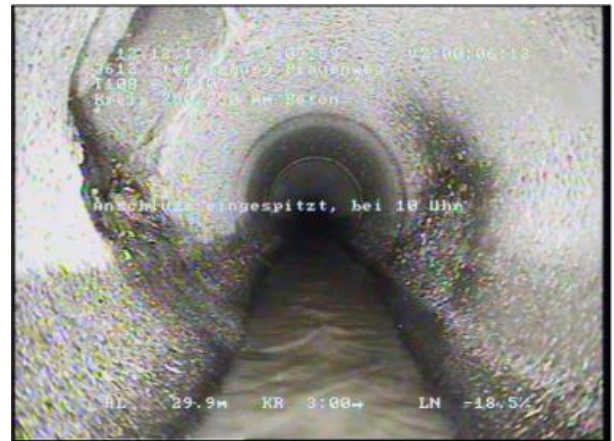
Abbildung 3: Nicht fachmännisch ausgeführter Einlauf, Rohrwandung porös
