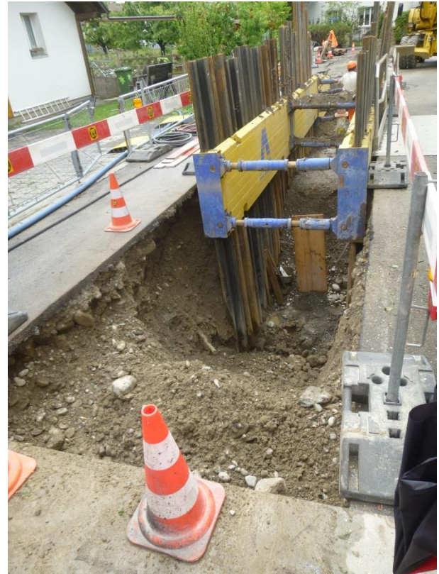
Abbildung 4: Material seitlich des Grabens auf Grund des rolligen Materials abgerutscht
