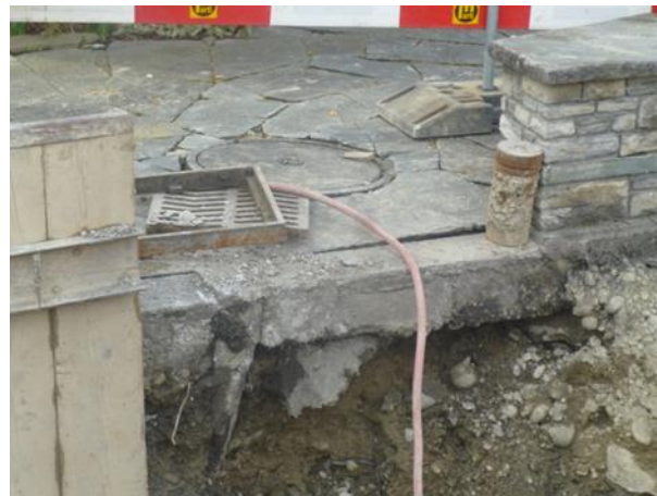
Abbildung 2: Randabschluss nicht einbetoniert
