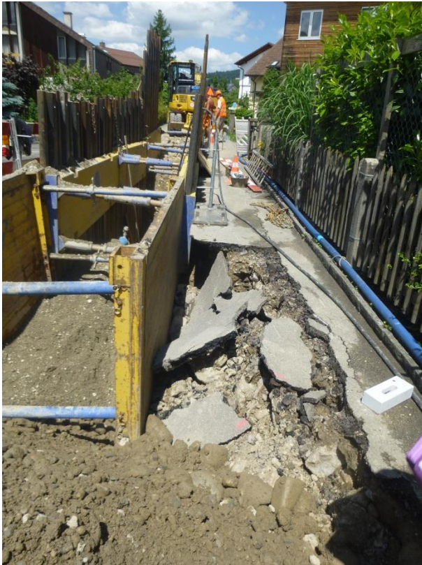
Abbildung 3: Material seitlich des Grabens auf Grund des rolligen Materials abgerutscht
