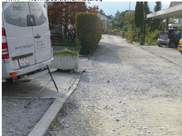
Abbildung 1: Randabschluss auf Grund schlechter Bettung beschädigt
