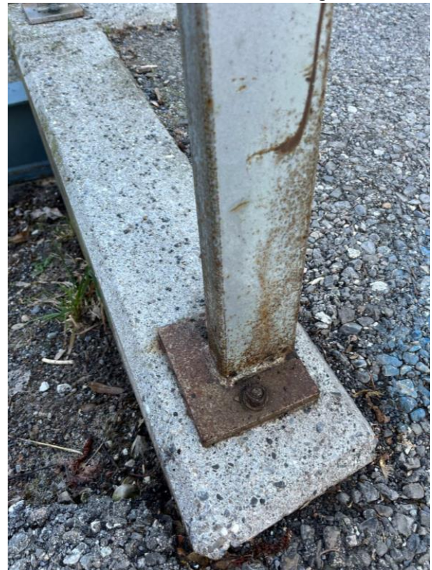
Korrosion am Geländerpfosten und Befestigungsanker
