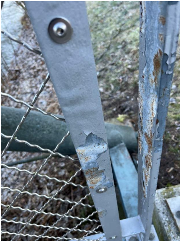
Farbschäden und Korrosion am Geländer
