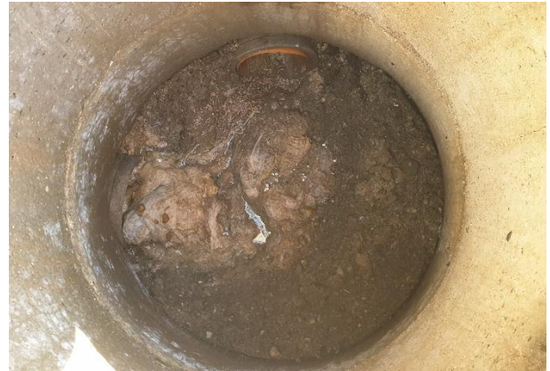
Fehlendes Bankett im Kontrollschacht führt zu Ablagerungen in der Schachtsohle. Der Abfluss ist nicht mehr gewährleistet.
