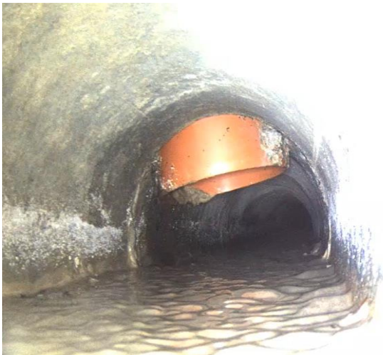
Verkalkte Sauberwasserleitung mit nicht fachmännisch ausgeführtem Anschluss
