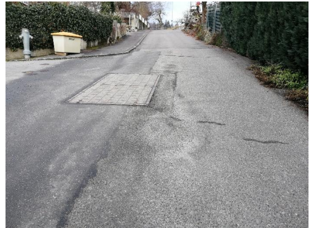
Starke Deformation der Strassenoberfläche
