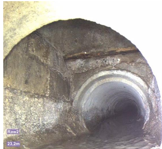
Schadhafter, überdeckter Kontrollschacht der Sauberwasserleitung
