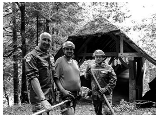
Truppenbesuch durch Guido Sohm bei der Instandstellung Wanderweg über die Koppisbrücke, v.l. Guido Sohm, Florian Fankhauser, Marco Ewert
