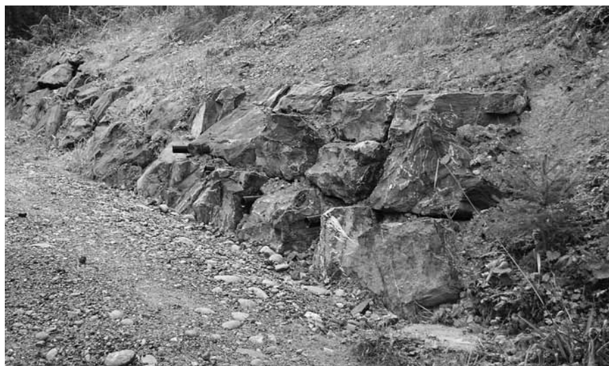
Wiederhergestellter Hangrutsch Neuenbann
